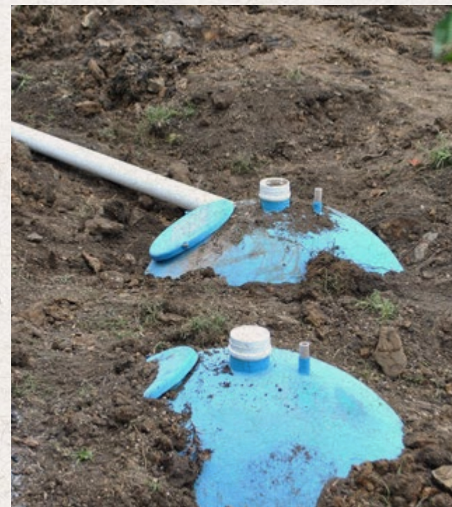
Conjunto de fossas e filtro anaeróbico. Fonte: Prefeitura de Caxias do Sul/RS, 2016.
