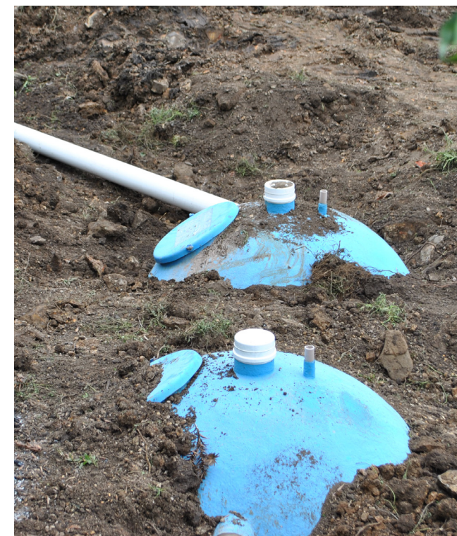
Conjunto de fossas e filtro anaeróbico. Fonte: Prefeitura de Caxias do Sul/RS, 2016.
