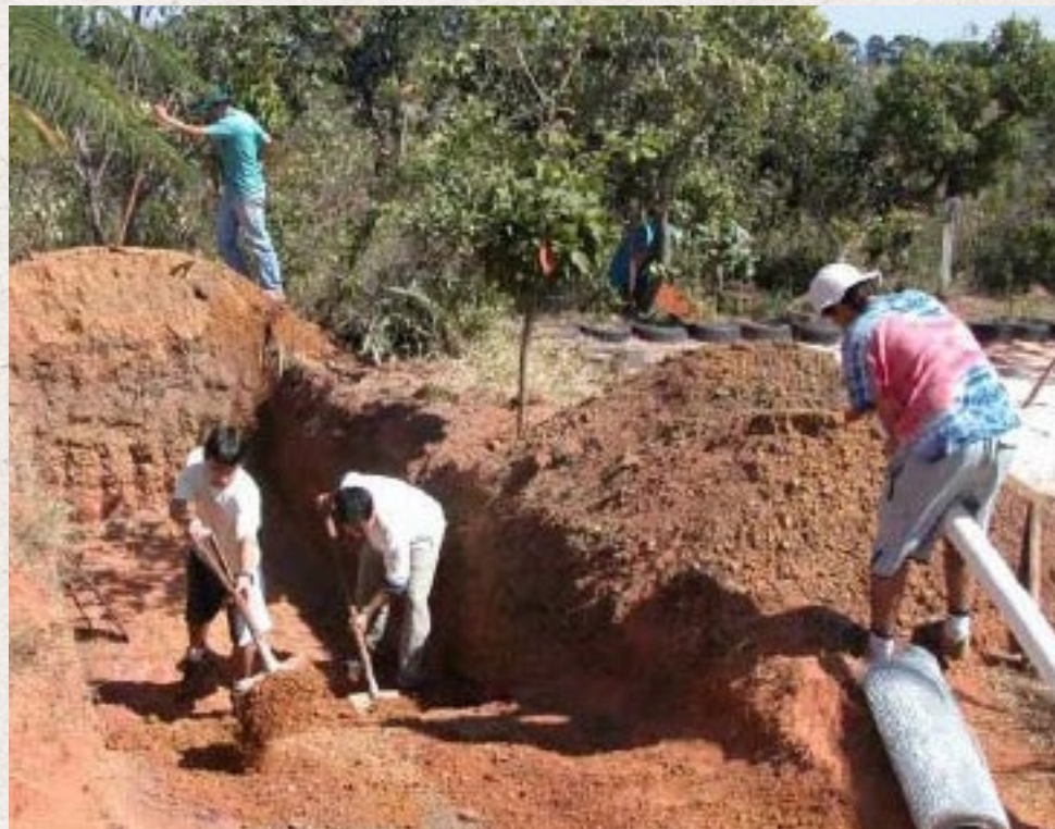
Abertura da fossa TEvap de forma manual. Fonte: Emater/MG, 2016.
